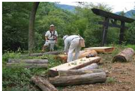
ベンチ設置場所 大雲寺自然探勝園遊歩道 6個 善光寺道念仏石付近 2個 猿ヶ馬場峠(聖湖湖畔) 2個
